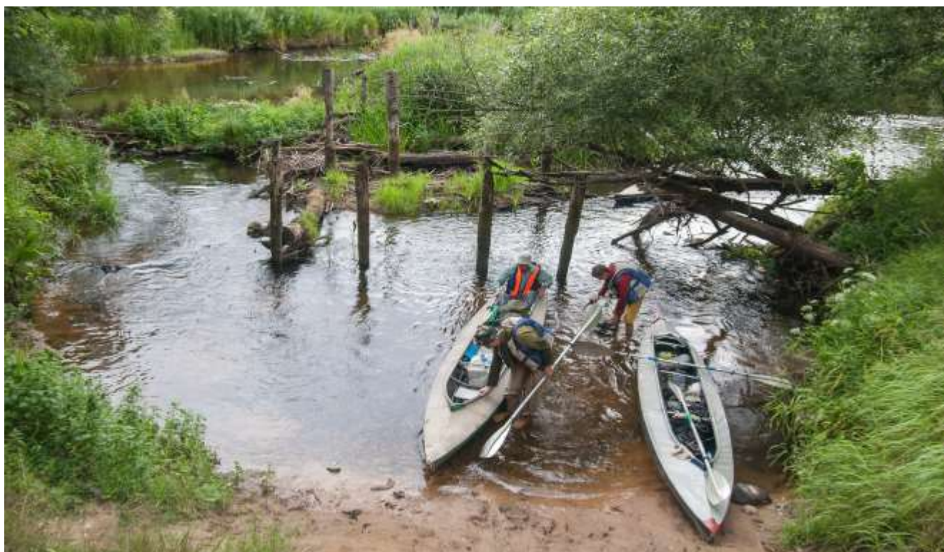
Фото № 13. Разрушенный деревянный мост перед деревней Симоновичи.
